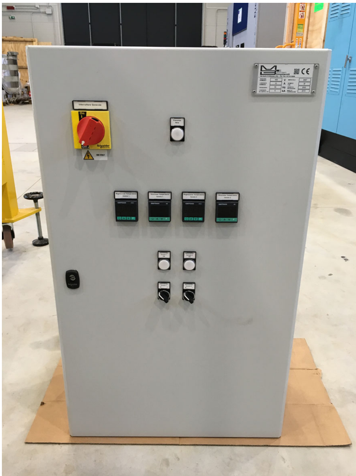
Quadro elettrico controllo termico testa adduttori da 20 kA
